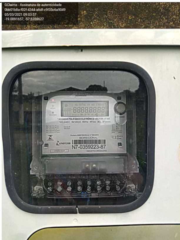
Identificação do quadro de energia
