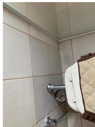
Vazamentos e infiltrações
