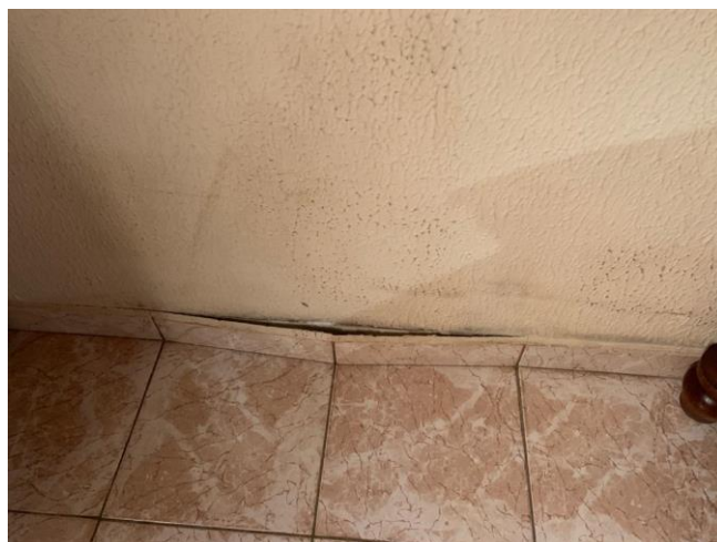
Necessita de alguns reparos
