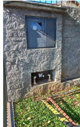
Medidores de consumo de água e energia
