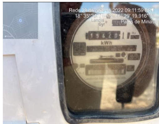
MEDIDOR DE ENERGIA ELÉTRICA
