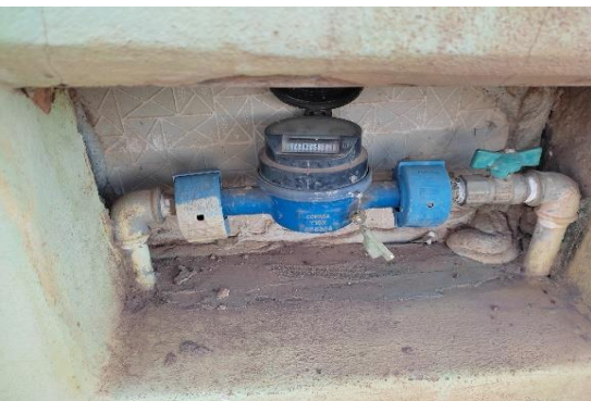
Medidor de água
