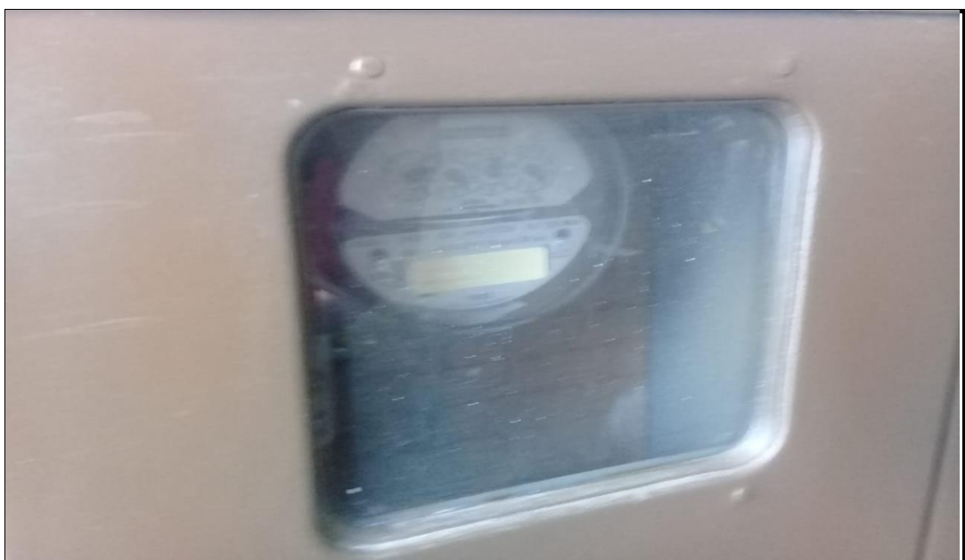
Descrição: Medidor de Energia
