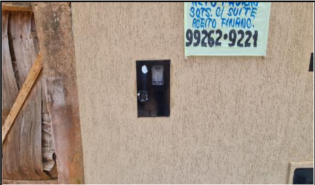
Descrição: MEDIDOR DE ENERGIA
