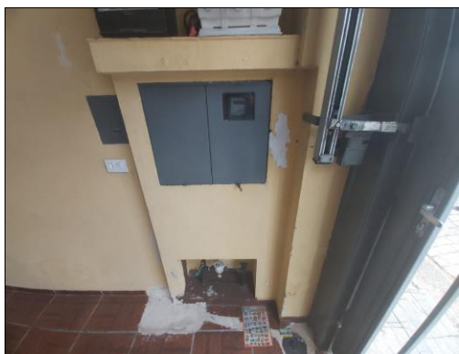
MEDIDOR DE ENERGIA ELÉTRICA / HIDRÔMETRO
