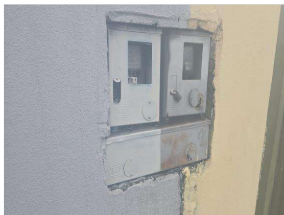
Descrição: Medidor de energia
