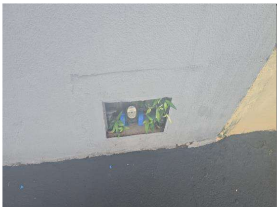
Descrição: Medidor de água
