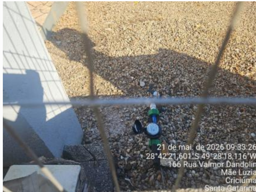
Medidor de água
