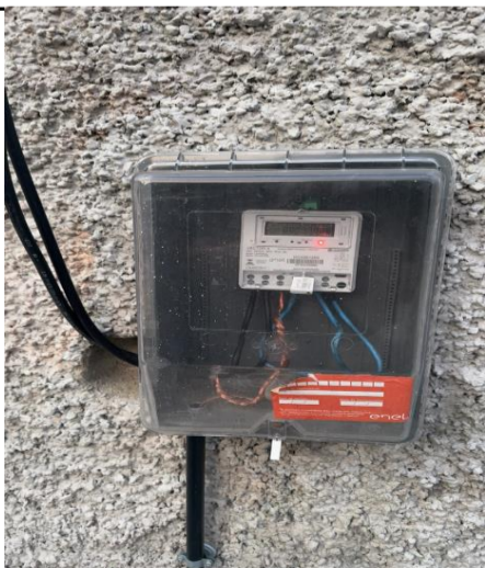
MEDIDOR DE ENERGIA ELÉTRICA
