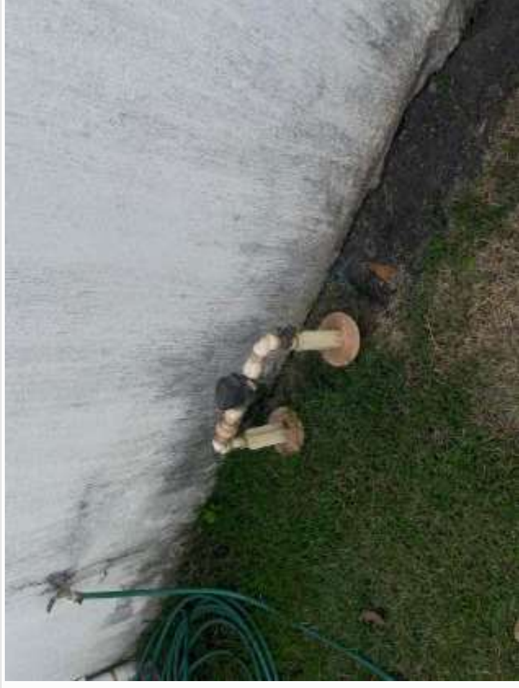
Medidor de água
