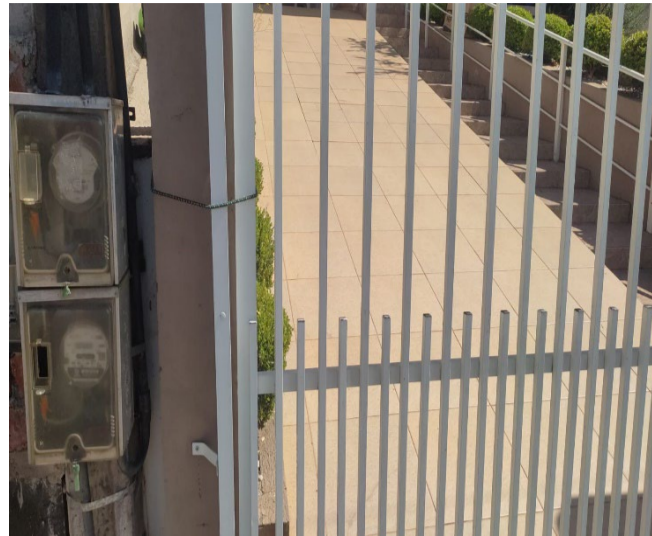
14 - Medidor de energia.
