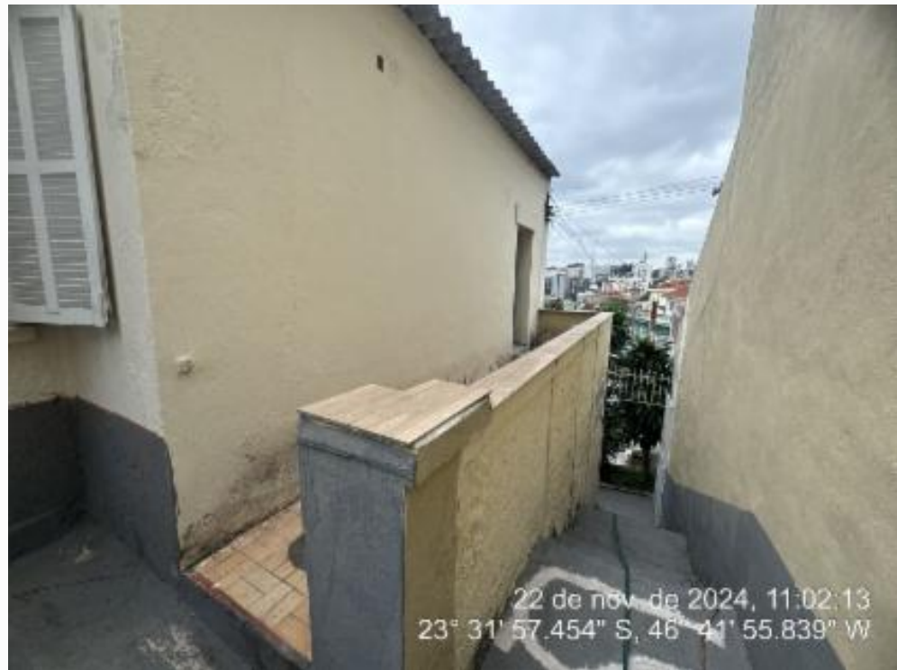
Corredor de acesso
