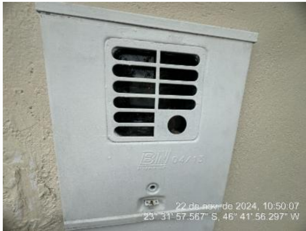
Quadro de energia
