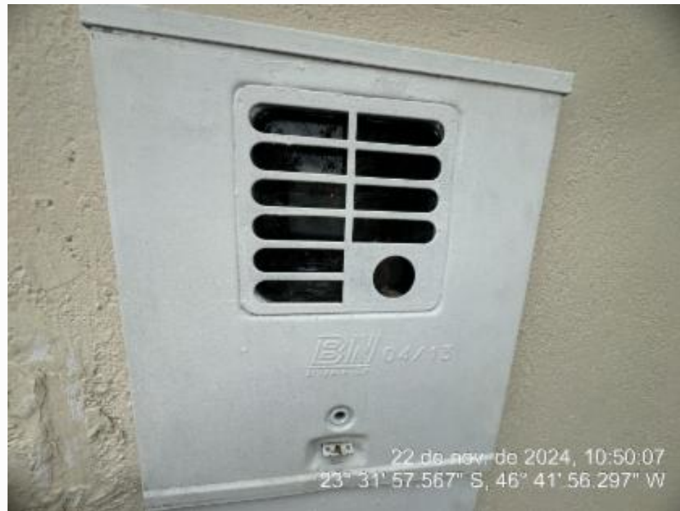
Quadro de energia
