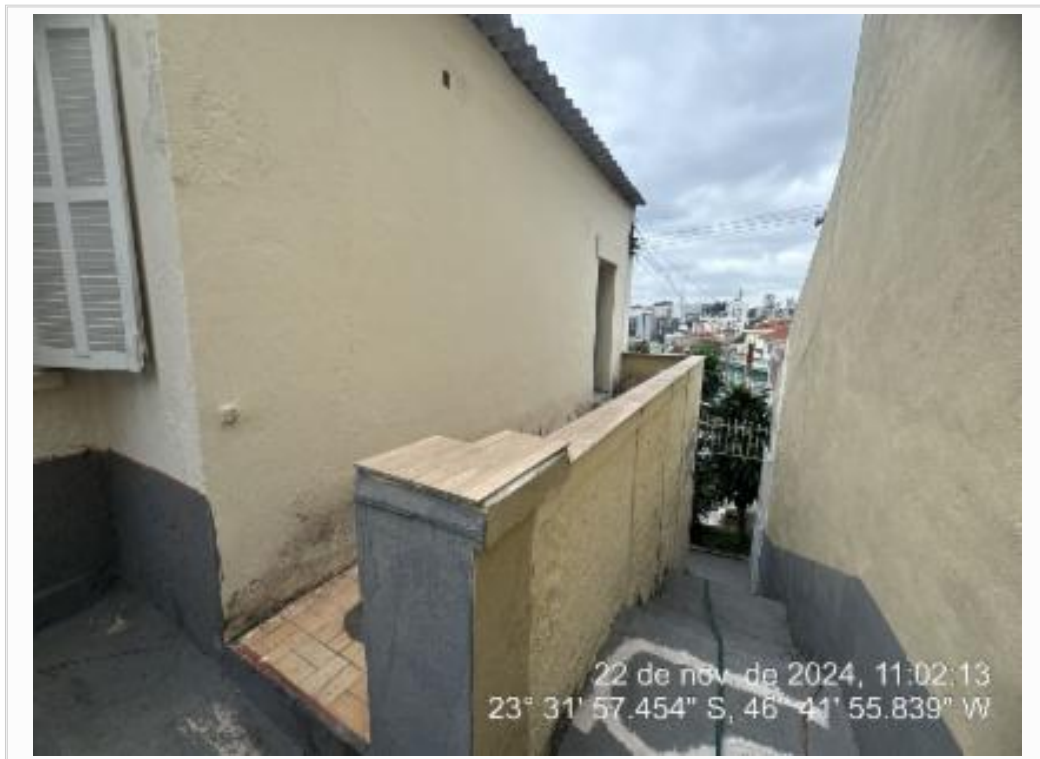
Corredor de acesso
