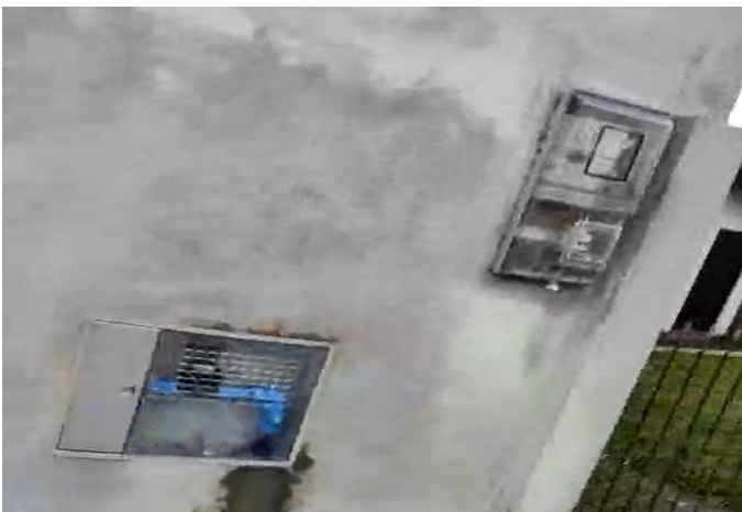
Medidor de energia e hidrometro
