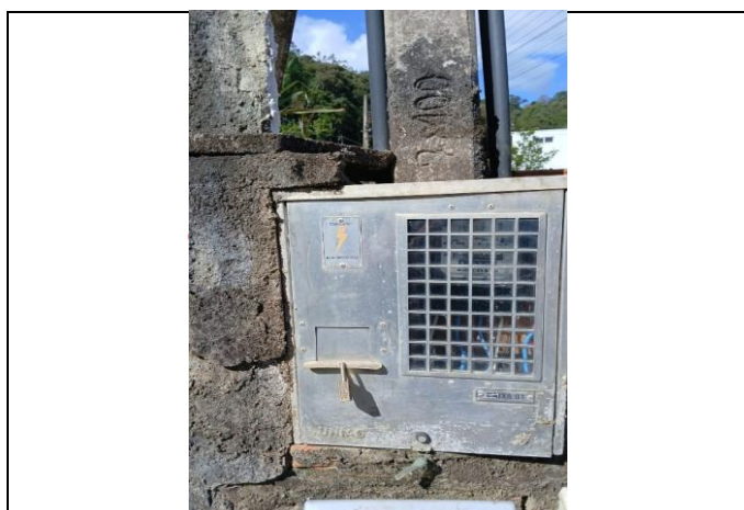
Medidor de energia
