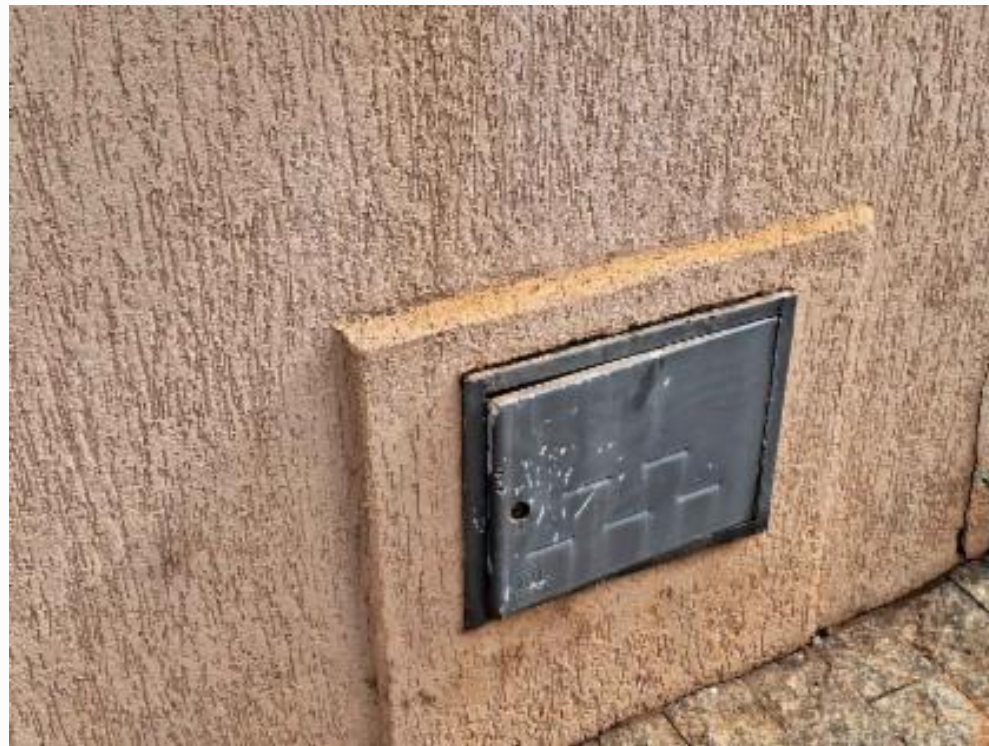
Medidor de água
