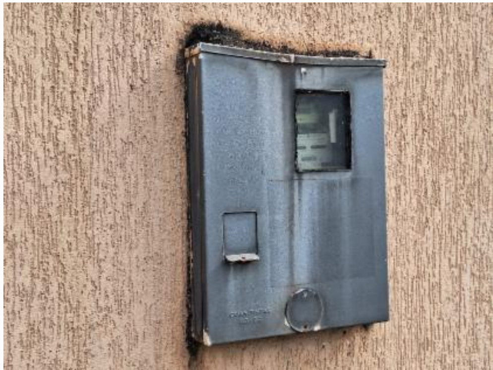
Medidor de energia
