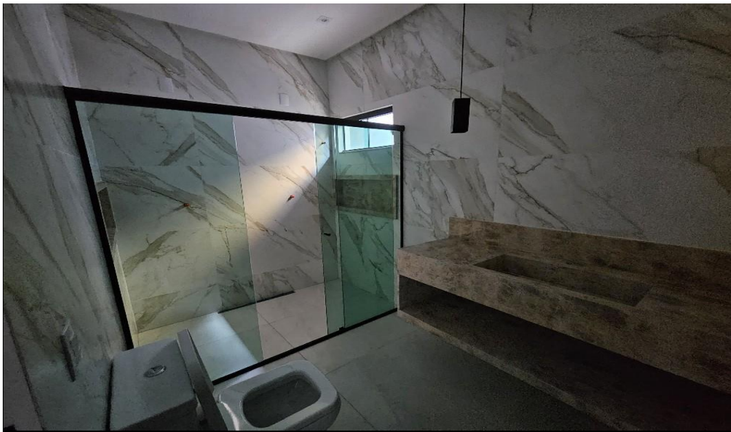
Descrição: BANHEIRO SUÍTE
