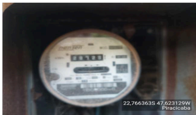
Descrição: Medidor de energia elétrica
