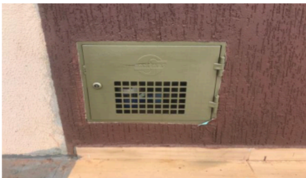
Descrição: MEDIDOR DE ÁGUA
