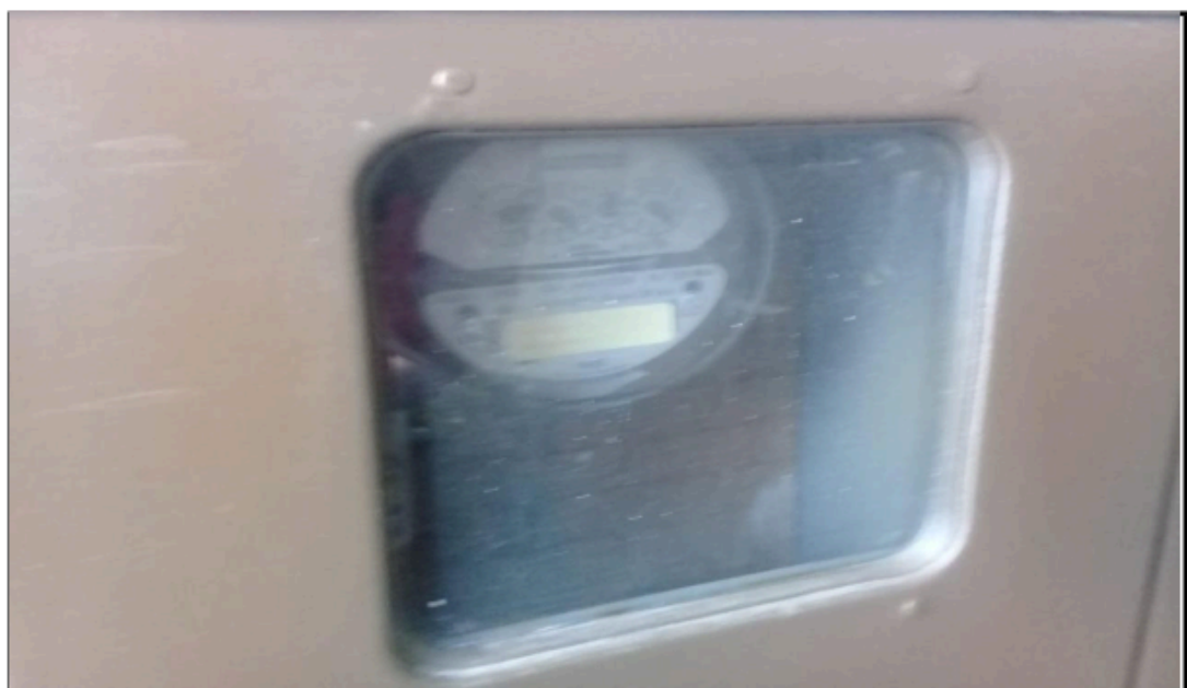
Descrição: Medidor de Energia
