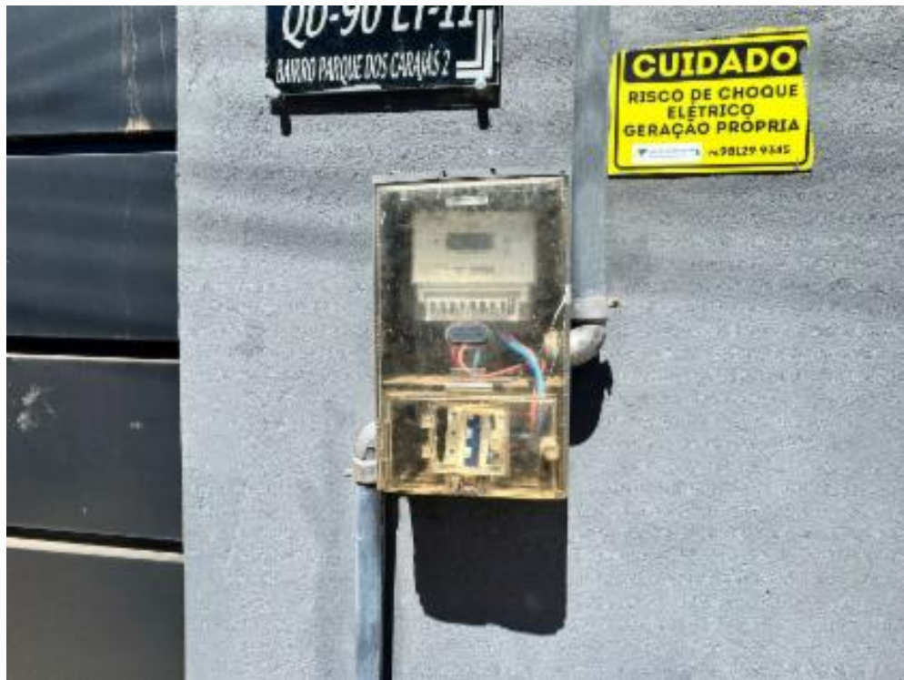
Medidor de energia
