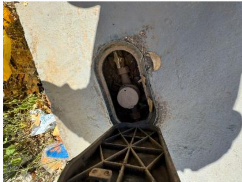
Medidor de água
