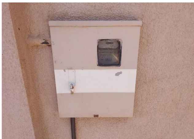
MEDIDOR DE ENERGIA
