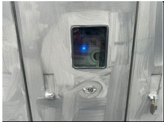
Descrição: Medidor de energia
