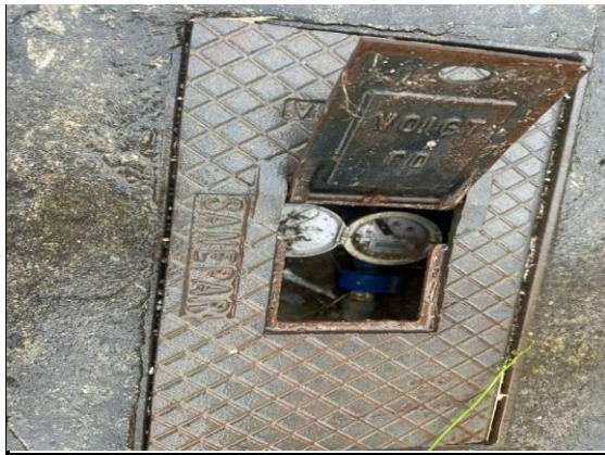
Descrição: Medidor de água
