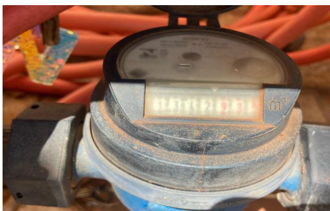
Descrição: Medidor de água
