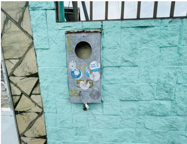
Medidor de energia
