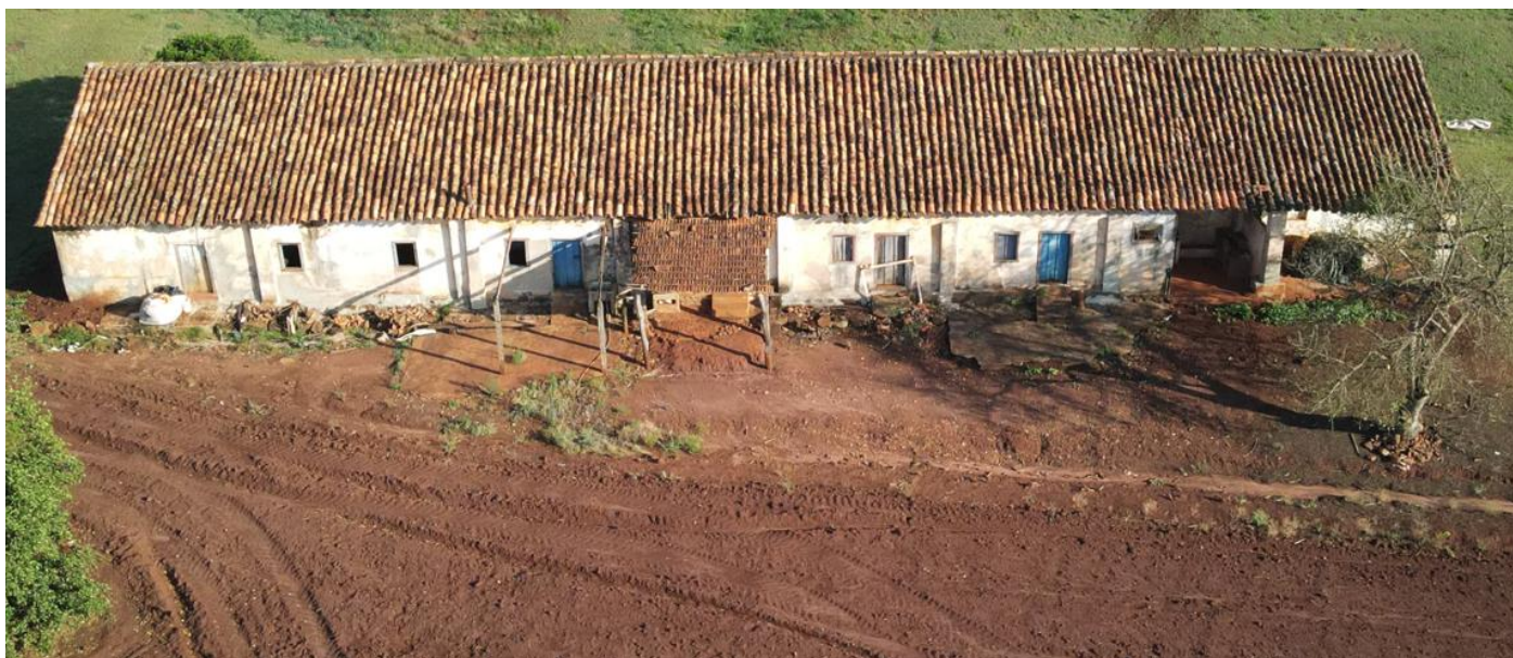
Figura 10 - Construção 1 - Casa de colônia antiga em baixo estado de conservação externo
