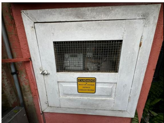
Descrição: Medidor de energia
