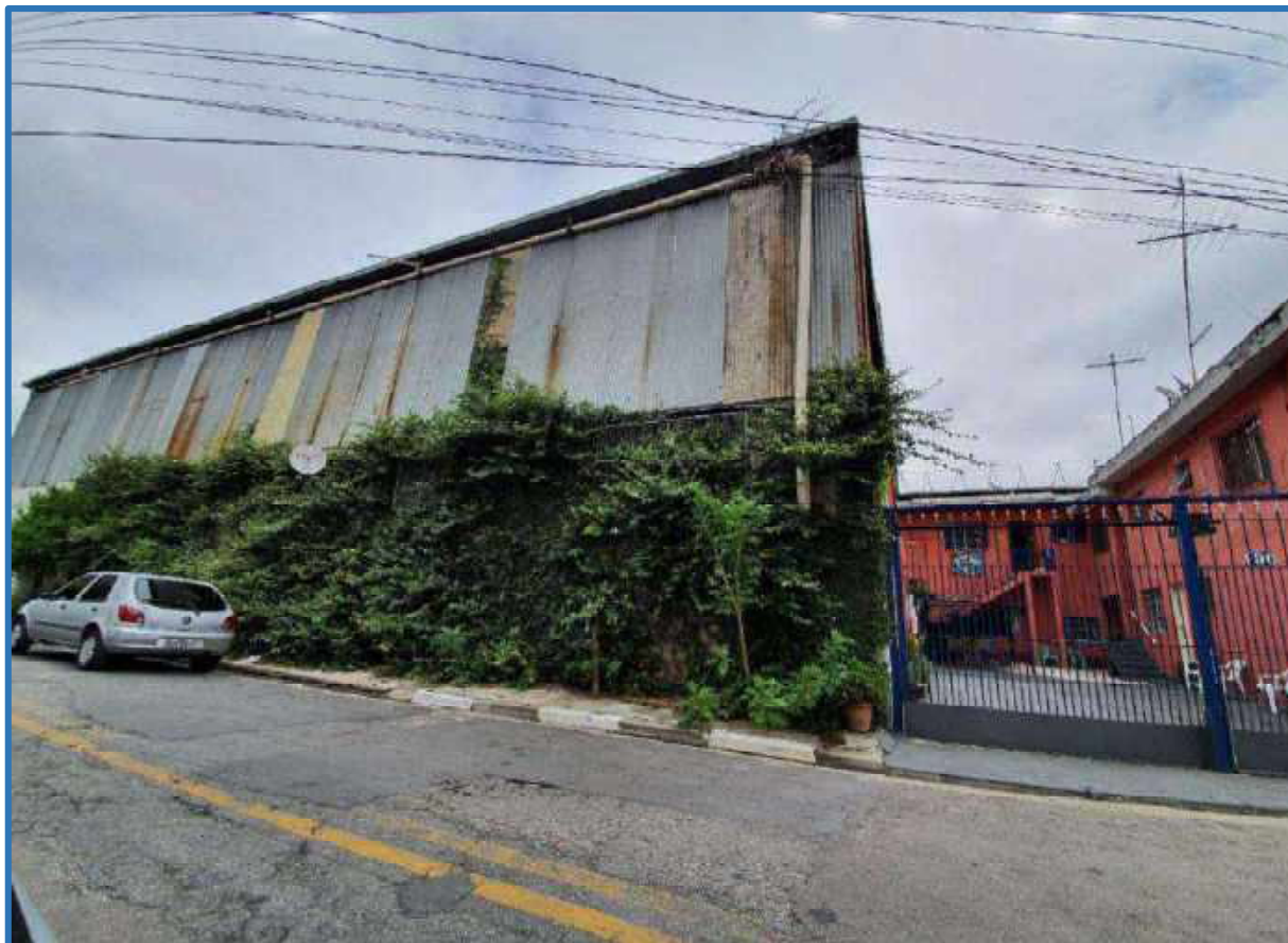
Foto 4 – Vista geral da frente do Lote 18, da Quadra 24, onde está situado o imóvel avaliando (Rua Rosa Cotine, nº 218 – Vila dos Remédios – Osasco – SP).
