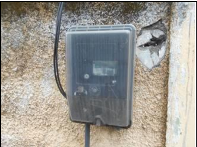
MEDIDOR DE ENERGIA
