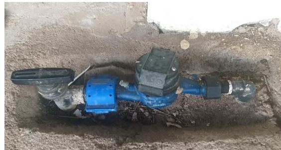
Medidor de água
