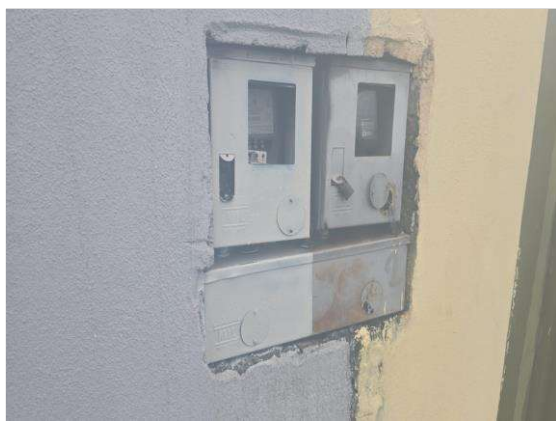
Descrição: Medidor de energia
