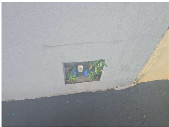
Descrição: Medidor de água
