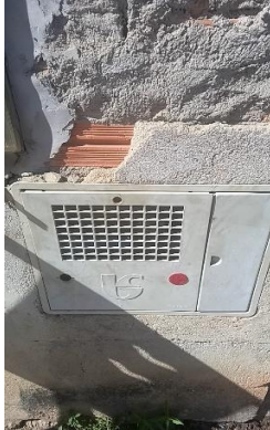
Medidor de água
