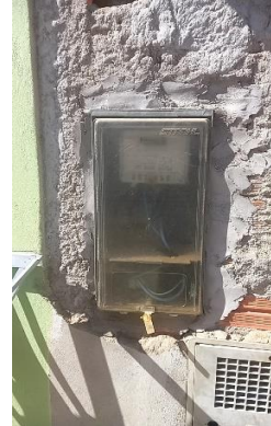
Medidor de energia
