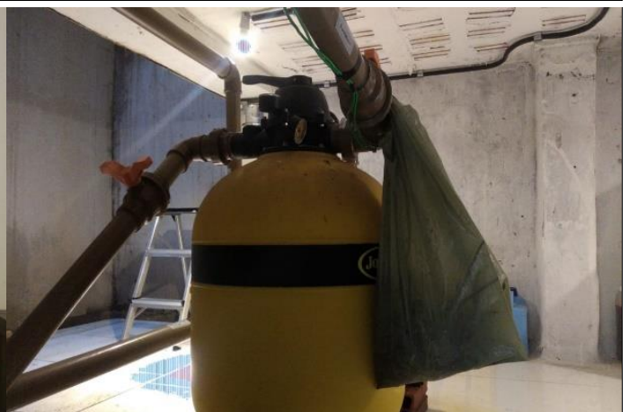
Casa de máquinas
