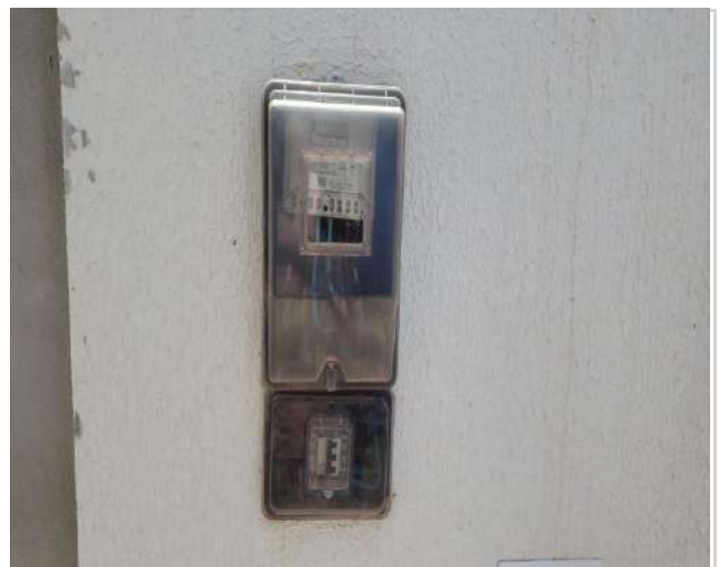
Medidor de energia
