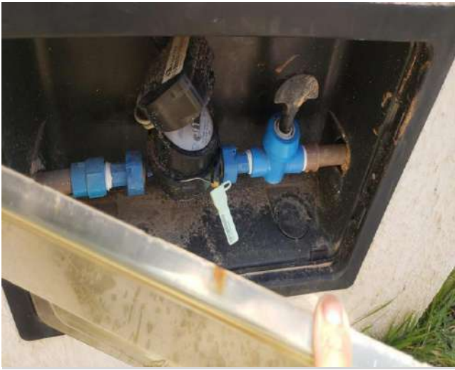
Medidor de água
