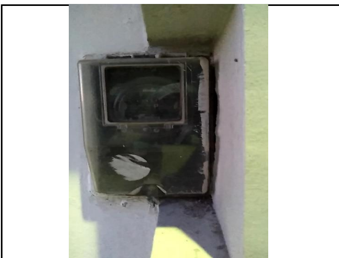
MEDIDOR DE ENERGIA ELÉTRICA
