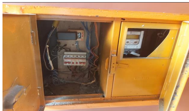
Descrição: Medidor de energia elétrica
