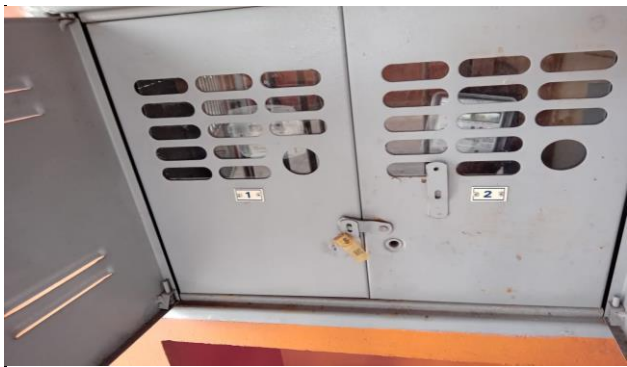
Descrição: Medidor de energia elétrica
