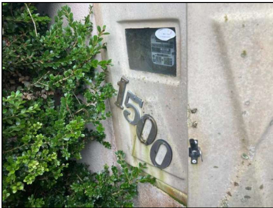
MEDIDOR DE ENERGIA
