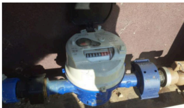
Descrição: MEDIDOR DE ÁGUA
