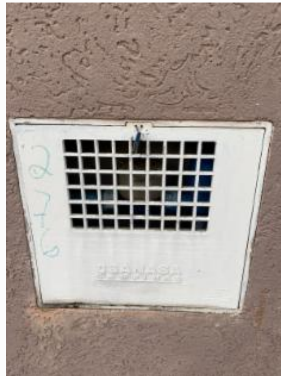
Medidor de água
