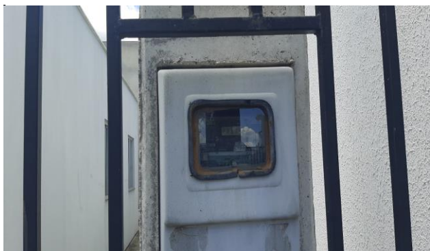
Descrição: Medidor de energia elétrica
