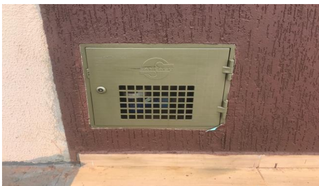
Descrição: MEDIDOR DE ÁGUA
