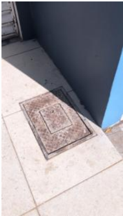
Medidor de água
