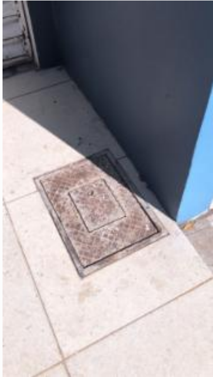
Medidor de água
