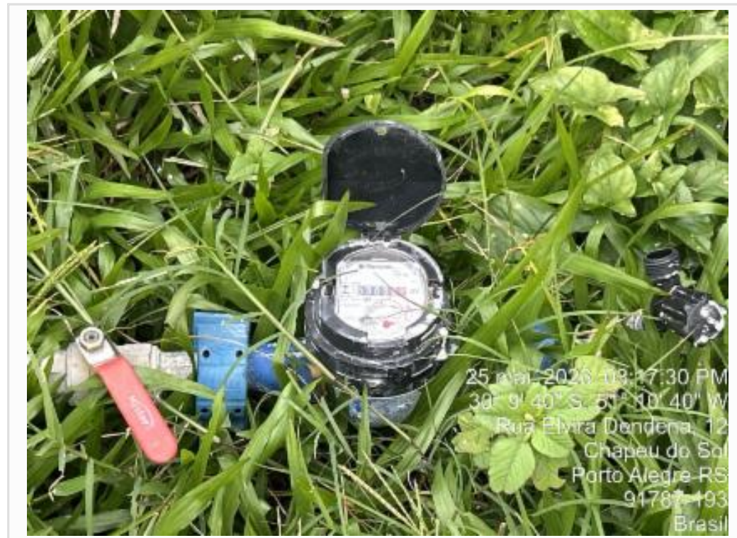
Medidor de água
