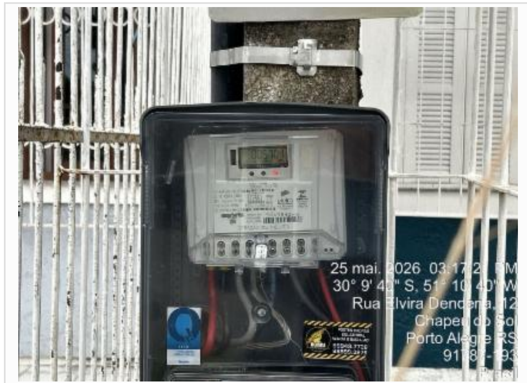
Medidor de energia
