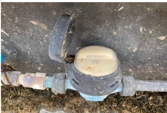
Medidor de água
