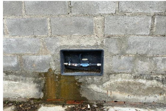
Medidor de água
