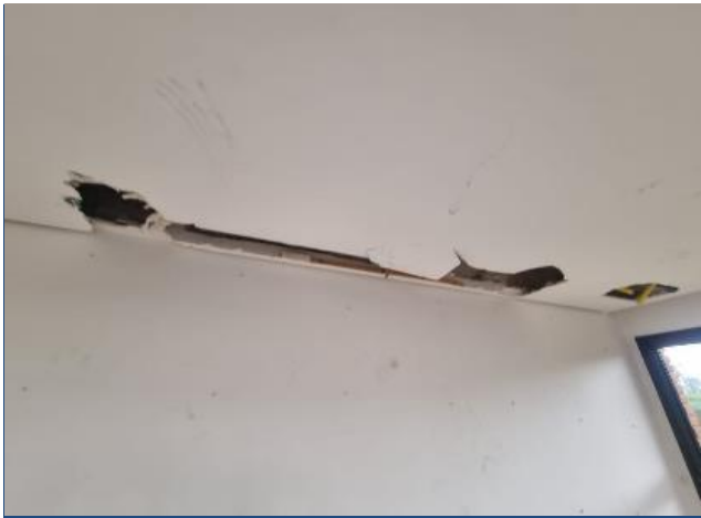
Sala 4 (danos no forro)
