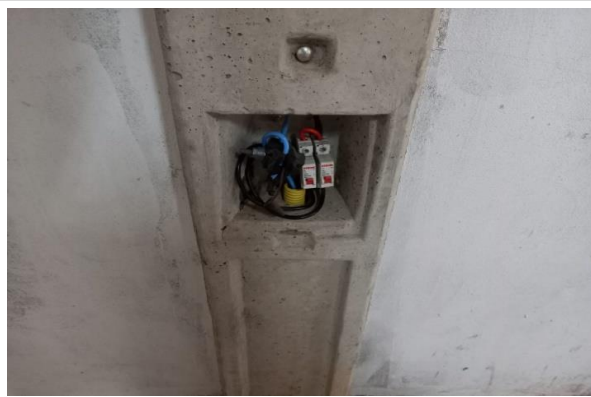
Medidor de energia
