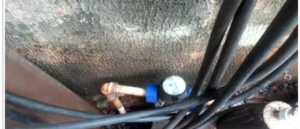
Medidor de água
