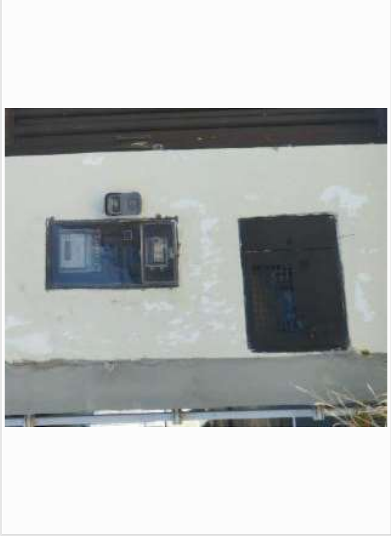
Medidor de luz/medidor de água
